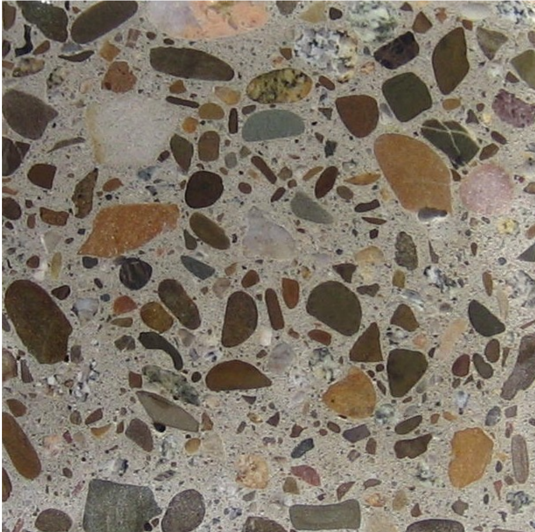
Fot. 2. Przekrój próbki żwirowego betonu C25/30, cement hutniczy, zastosowanego w oczyszczalni ścieków do betonowania całości konstrukcji: wielkowymiarowych fundamentów i ścian reaktorów, ale także stosunkowo cienkich płyt fundamentowych, ścian, komór i kierownic w osadnikach.
