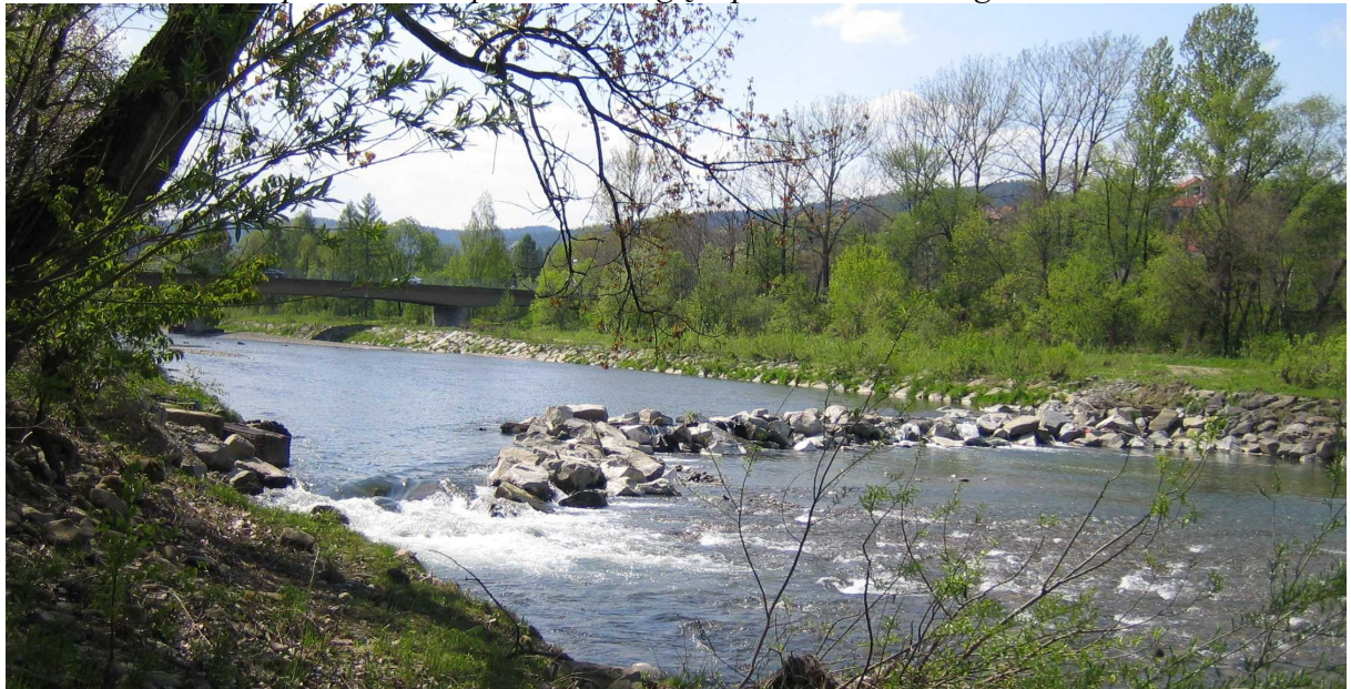
Ujęcie wody w Myślenicach, dno rzeki obniżyło się tutaj o prawie 2m, odsłaniając ściankę szczelną oryginalnie wbity na poziomie dna rzeki. Dzięki uprzejmości zarządu wodociągów w ściance zrobione jest przejście dla ryb
