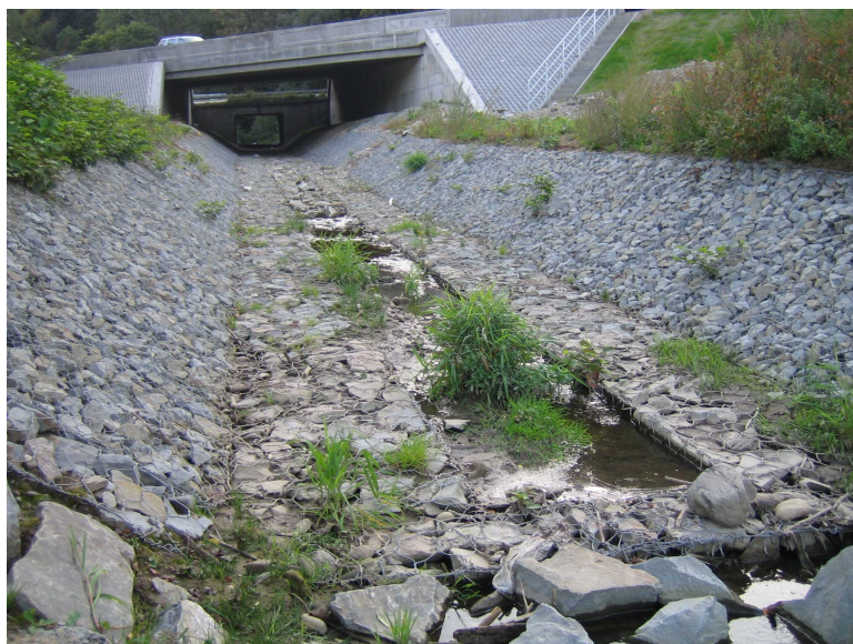
Zanik przepływu potoku Miłogoszcz w korycie umocnionym gabionami w rejonie mostu drogowego
