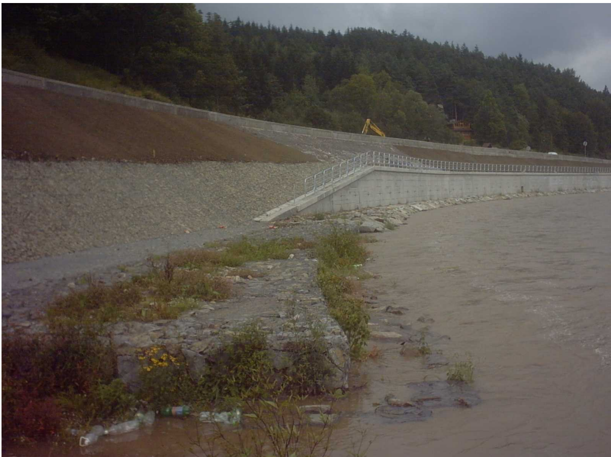
6. Gabiony zastosowane właściwie – nie przylegają do lustra średniej wody. Widoczny estetyczny i niski mur oporowy obłożony głazami i z zieloną skarpą na skraju drogi. Strach pomyśleć co by było, gdyby taki elegancki mur zastąpić gabionami...
