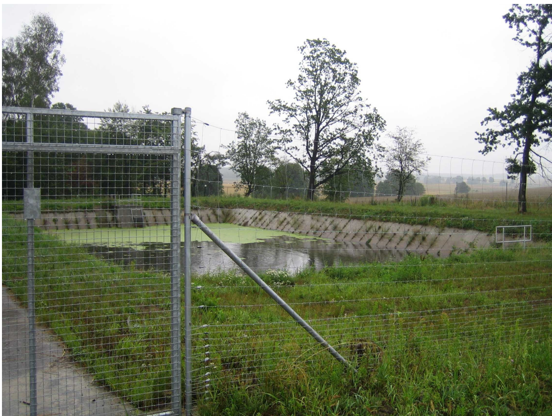
3. Zbiornik retencyjny ogrodzony siatką i z betonowymi skarpami na tle lasów i pól
